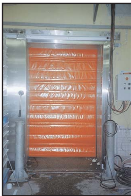
Mavicold monterad på kalla sidan inne i frysrummet. Manuell frys skjut port som nattstängning.
